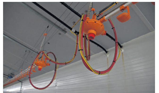
Plusieurs systèmes de purges existent. Ici, une vidange manuelle avec évacuation à l'extérieur du bâtiment.
